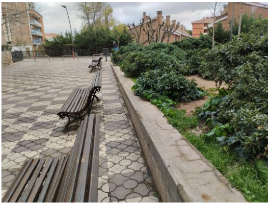
Muret a reparar
